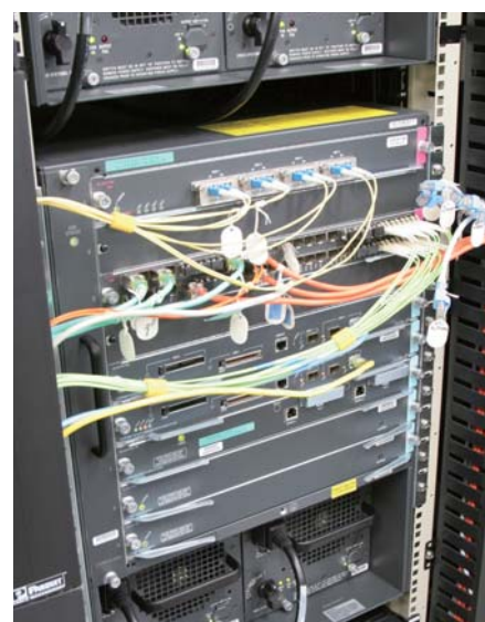
JAIST情報科学センター棟のサーバールームに設置されたCisco Catalyst 6500、無線LANコントローラー Cisco Catalyst 3560、ロケーションアプライアンスCisco 2710。これらのJAIST高度無線LAN管理システムは全て冗長構成となっている。
