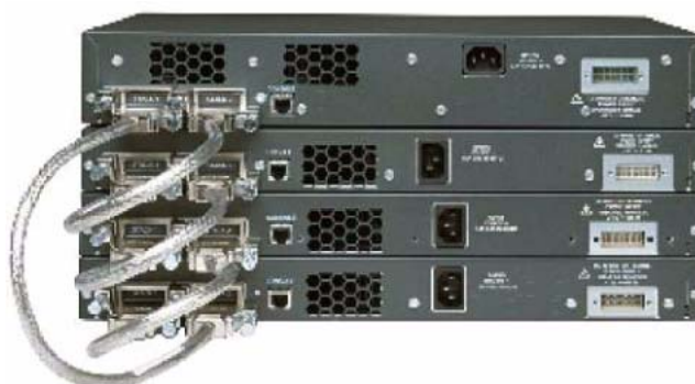
図 3 Cisco StackWise テクノロジーの復元力のあるケーブル接続
