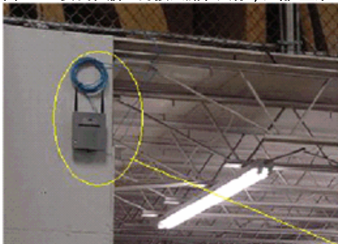
圖19 — 安裝在牆上的接入點和天線，遠離I型梁
