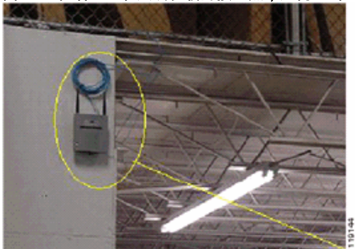
图19 —在墙壁上和天线装载的接入点，远离I型梁
