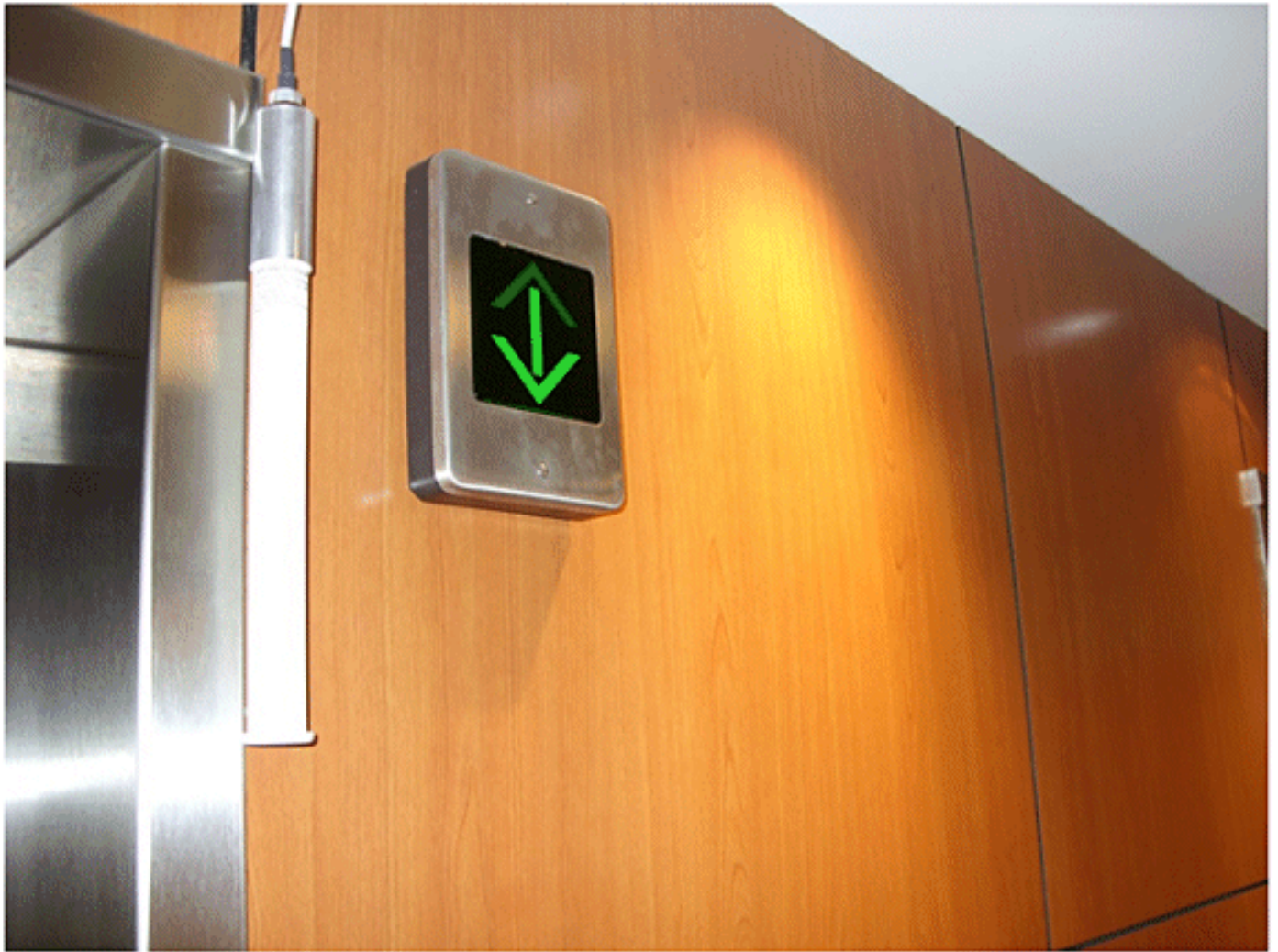
Figura 13: Posizionamento dei punti di accesso inadeguato - punti di accesso vicini
