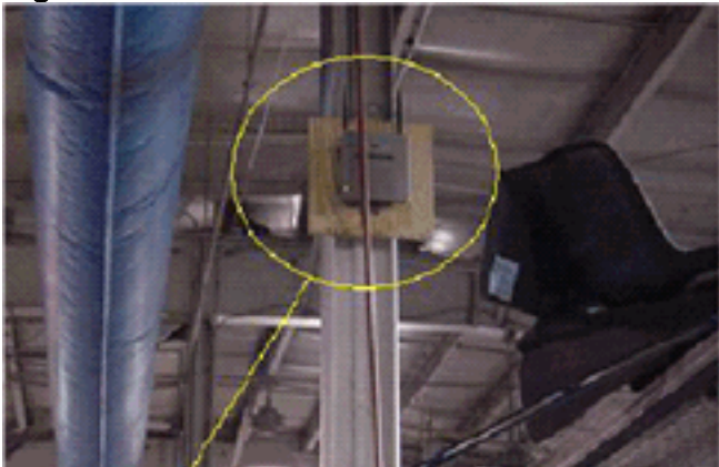
Figura 17 - Posizionamento non corretto delle antenne vicino a un raggio I
