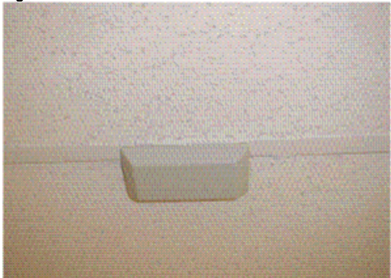
Figura 22 - Antenna Cisco Aironet 5959 installata a soffitto
