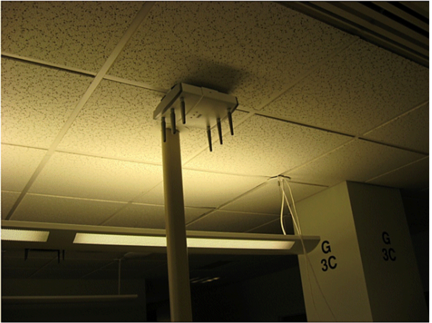
Abbildung 12: Schlechte Platzierung des Access Points in der Nähe physischer Hindernisse
