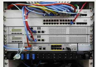
外部ネットワークとの接続に高機能ファイアウォール MX400 (下段) を利用。L3 スイッチ MS350-48 を通じて工場内にネットワークを分岐 (上段)
