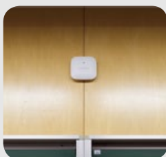
教室内に設置されたアクセス ポイント
