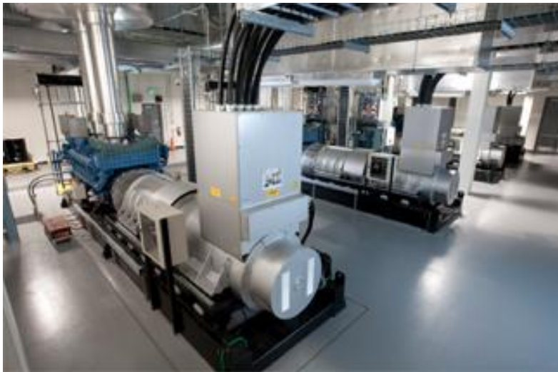
図 6 Allen Data Center の無停電電源供給装置 (UPS)システム
