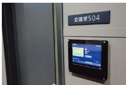
会議室の入退室を管理するタブレットも無線 LAN でつながっている
