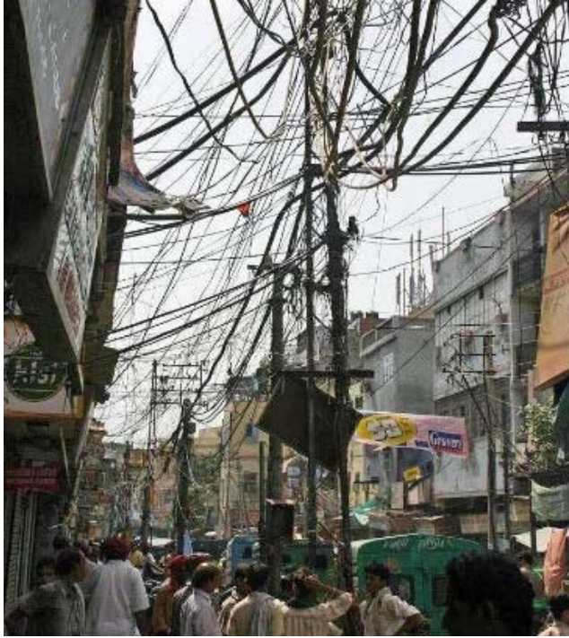
Figura 5. Ineficacia del servicio de suministro eléctrico en la India.
