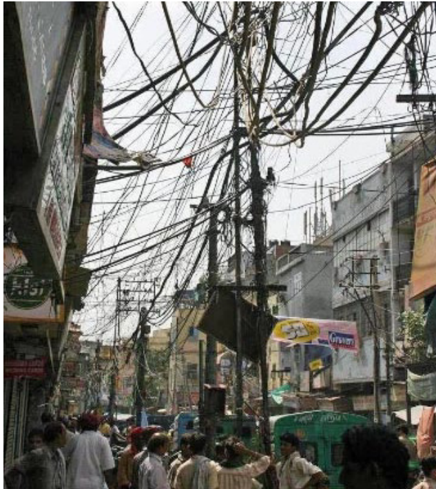
Abbildung 5. Ineffiziente Stromversorgung in Indien.
