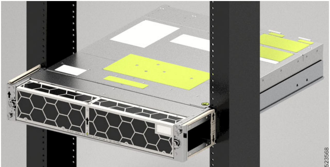
Figura 62: Marco de aire instalado
