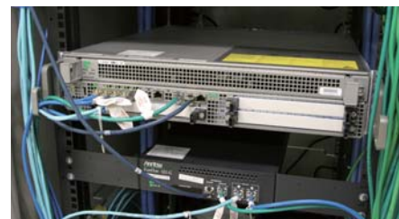
ブロードバンド映像配信サービス「ひかりTV」向けに実稼働中のASR 1002。IPv6マルチキャスト配信で中心的役割を担う。
