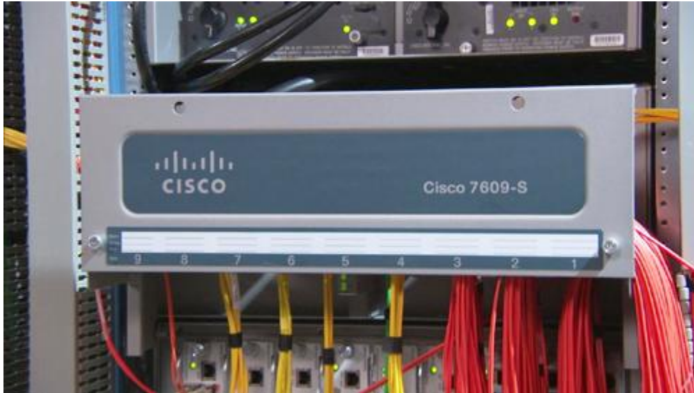
Cisco 7609-S、テストで使用したユーザー収容プロバイダー エッジ (uPE) 装置の 1 つです。
