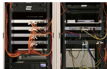
庁舎内のネットワークスイッチ。コアはCisco Catalyst 3750G、ディストリビューションはCisco Catalyst 2960である。Cisco Aironet 1240AGはCisco Catalyst 2960に接続されている。
