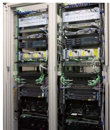
広島市庁舎内に設置されているCatalyst6506。2台での冗長構成となっている。
