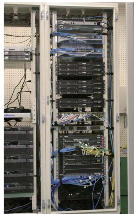
Cisco Nexus 5000等が設置されているラック。以前はネットワーク機器とOpengateサーバー、無停電電源装置で4本のラックを使用していたが、現在ではこれらがラック1本半のスペースに収容されている。
