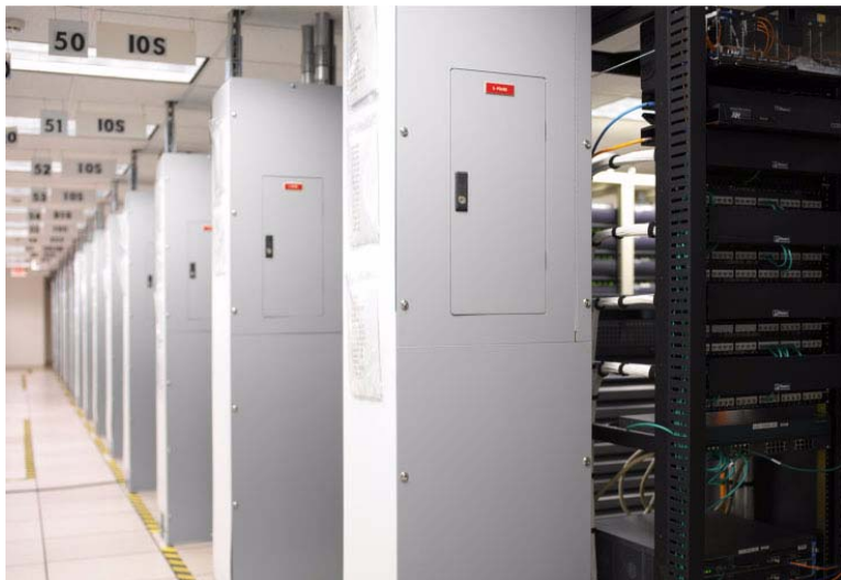
図 1 データセンターに置かれた大量の物理的デバイス
