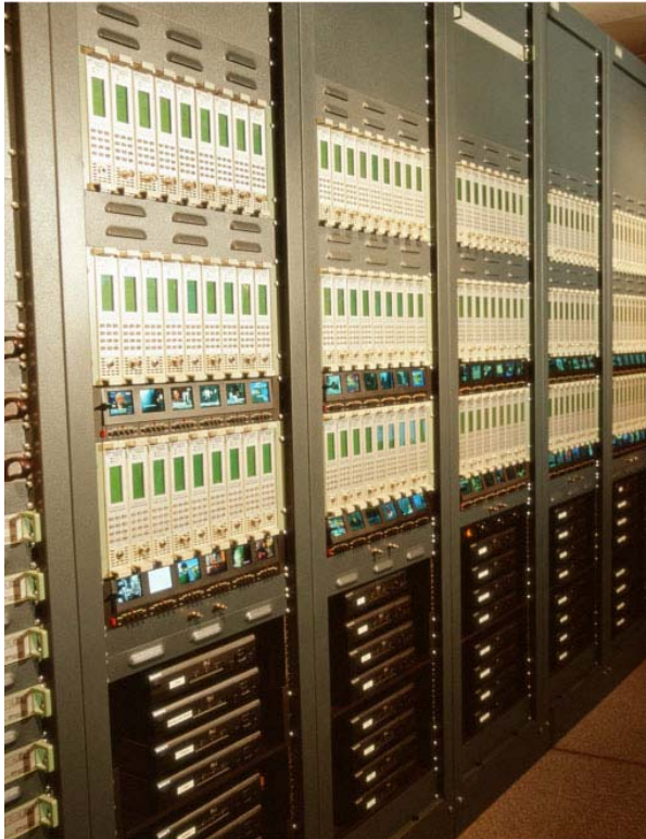
図 2 データセンター リソースの一般的なラック
