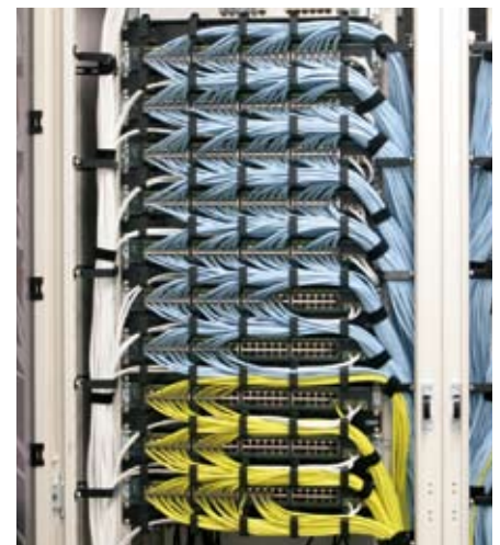
ATS 本社 9F マシンルームに設置されたコアスイッチの Cisco Catalyst 6509-E (上) / ATS 本社メインオフィスである 10F のラックルームに設置されたスイッチ Cisco Catalyst 3750G (下)
