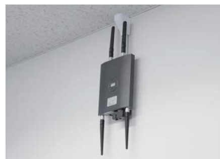
本社8階の壁面に設置されたアクセスポイント
