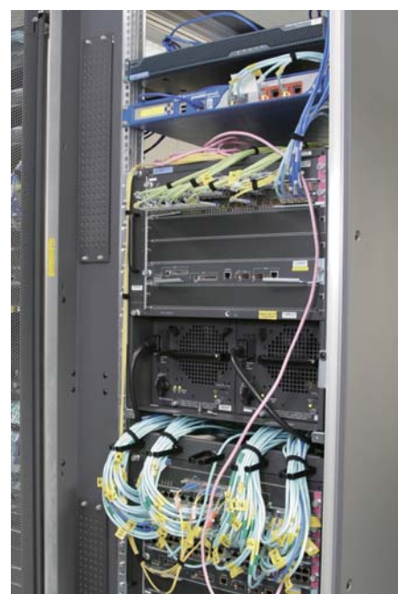
専修大学情報科学センターに設置されたシスコのネットワーク機器
