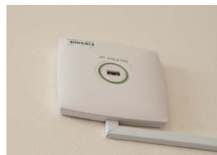
Cisco Wireless IP Phone 7920を使用し、スタッフと連絡をとっている(上)。壁に取り付けられたCisco Aironet(下)。
