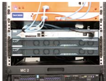
新データセンターのコアスイッチに採用された Cisco Catalyst 6500 (上) / Cisco ASA 5500 を活用して VPN 接続サービスを提供している (下)
