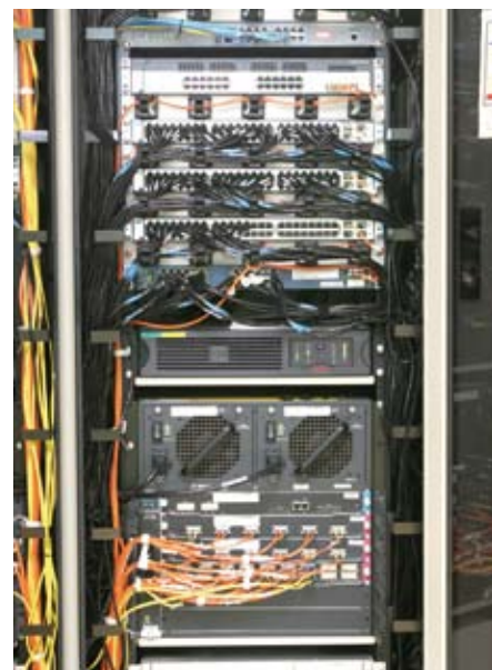
サイテックセンターのマシンルームに設置された、Catalyst 3740 (上)、Catalyst 3550 (中)、Catalyst 4506 (下)。
