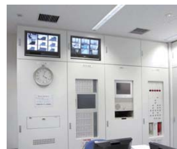
(上)各室の入口に設置されたタッチパネル式設備制御パネル。(下)ビル内のセキュリティ機器や空調、照明制御をモニタリングする防災センターの監視パネル。
