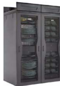
図 3 Cisco MDS 9513 スイッチ 2 台とファイバ接続ケーブルを収容した Panduit Net-Access キャビネット
