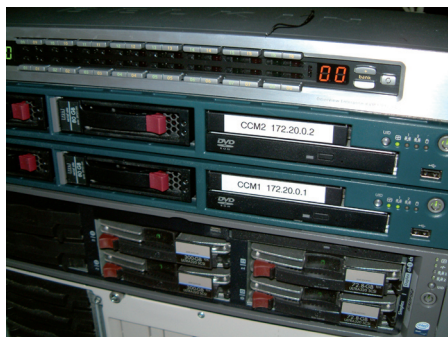
Server im Rechenzentrum des Landratsamtes
