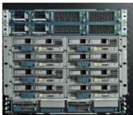
Das Cisco UCS im Einsatz
