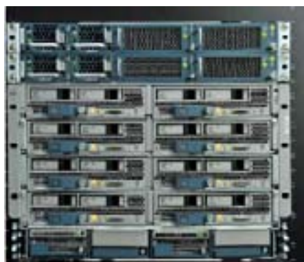
Das Cisco UCS im Einsatz
